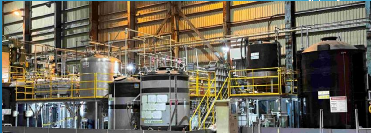
パイロットプラント全景
